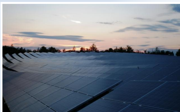
Centrale Solaire du SYCALA Département : Lot (46) Puissance électrique : 8 000 KWc Mise en service : Juin 2011
