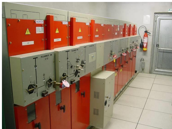
Intérieur d'un poste de livraison
