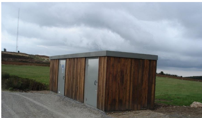
Poste de livraison du parc éolien du MARGNES (81)
